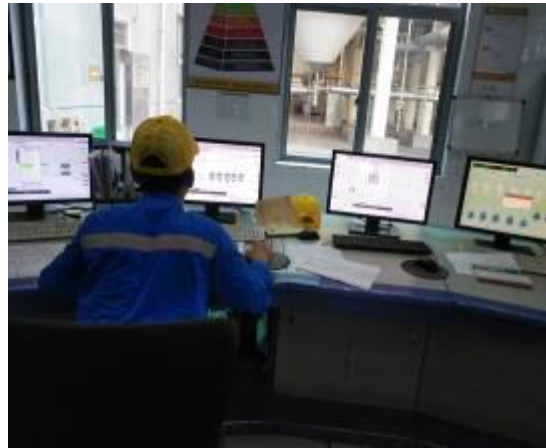
实习学生在国威利用组态对生产机器进行控制
